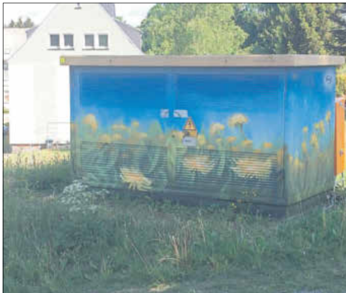
Stromkasten am neuen Baugebiet „Bürgerwäldchen“
